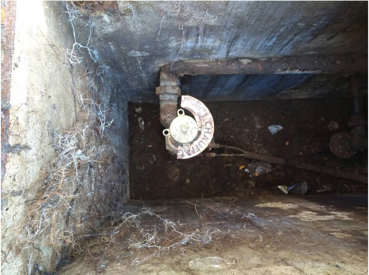
Citerne de mazout de chauffage de 3.000 litres) Huisbrandolietank van 3.000 liter
